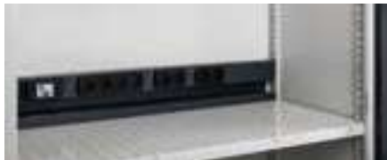
Anbringung des Energiekanals im oberen Bereich des Lochbodens/der Lochplatte
