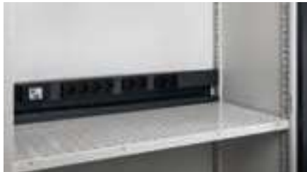
Anbringung des Energiekanals im oberen Bereich des Lochbodens/der Lochplatte
